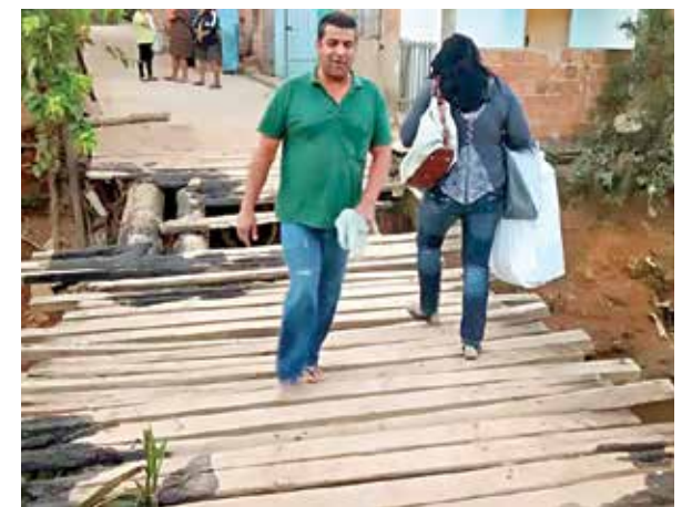
■ Lili da Barbearia alertou para o conserto da ponte do bairro Pro-Morar I que oferece risco aos moradores
